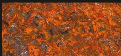
Sin tratamiento de protección contra la corrosión
